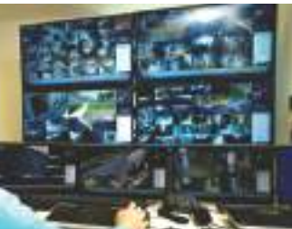
CCTV Control, server room хяналтын камерын удирдлага, архивын өрөө
